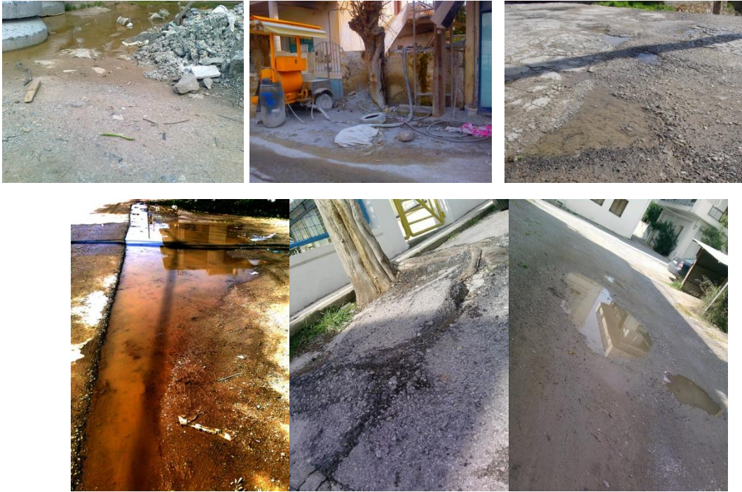
Λακκούβες και κακοτεχνίες στους δρόμους
